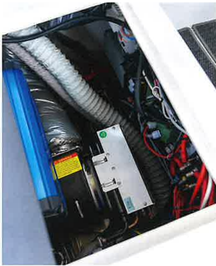
メインキャビン左舷側のシートの下の狭い空間に、マリンエアコン本体(中央の白い機器)が収まっている。室外機も不要だ。左に見える青い機器はインバーター
