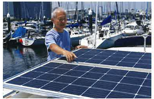
175Wのソーラーパネル2枚をハウスの屋根に設置。晴れていれば、2日もあれば200Ahのバッテリーが満充電になっているので、まずは5時間連続でエアコンが使用できるという
