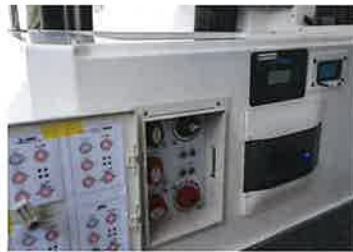
エアコンが設置してあるシートの座面下には、電源供給経路の切り替えスイッチ(中央)や給電やバッテリー残量を確認するメーター(右奥)などを設置している
